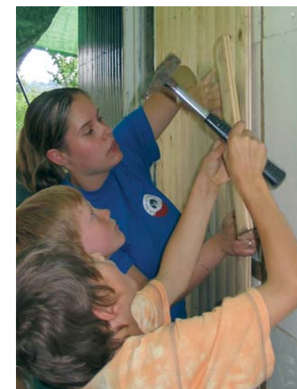
Erst Styropor, dann Holz: Die Seiten wurden gedämmt und mit neuen Brettern verkleidet.
